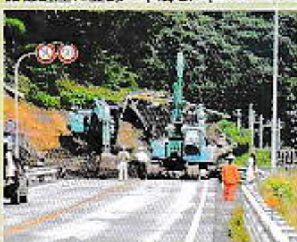
7月豪雨で甚大な被害 平成 30 年
